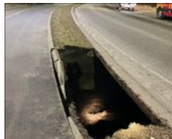
SYNKEHULL: Slik så det ut i Haukelivegen like etter at kommunen fikk melding om hullet. FOTO: HAUGESUND KOMMUNE
