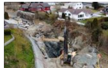
STORT: Det ble et enormt arbeid med å få sikret og ordnet synkehullet. Bildet er tatt rundt to måneder etter at det oppsto. FOTO: ALFRED AASE
